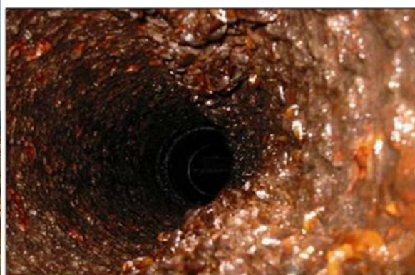
Tubulação infestada pelo Mexilhão Dourado. (CORSAN - 2008).
